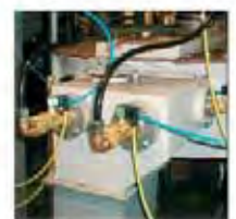
Toberas especiales para inyección de agua pulverizada
