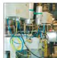
Tanques de agua y paneles de control del ElevatorEX®
